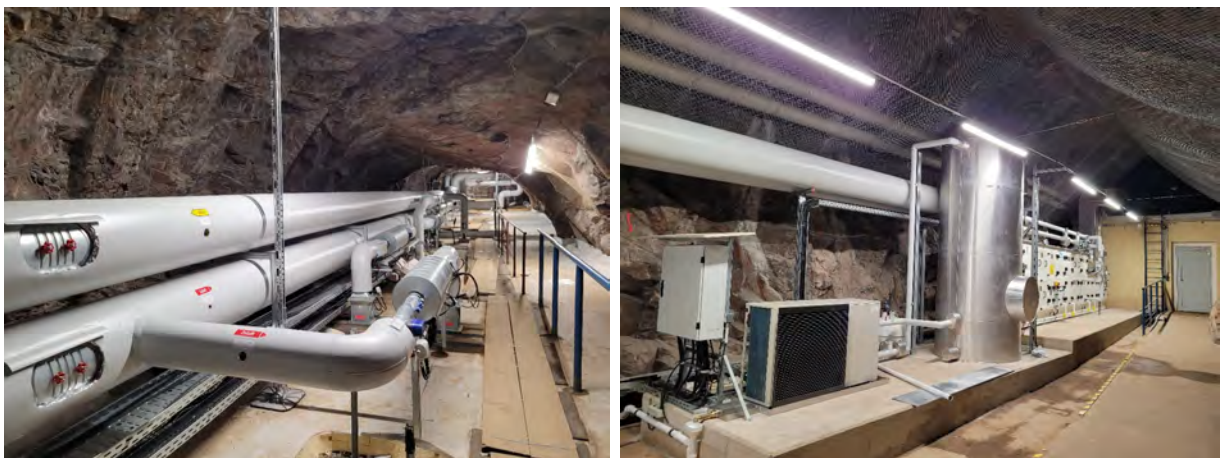
Abbildung 3-1: Neu errichtete Lüftungsanlage im Felsenkeller
