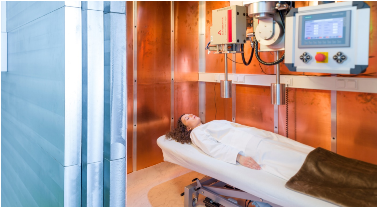
Abb. 4-12 Neue Abschirmkammer für den Ganzkörperzähler der Inkorporationsmessstelle des VKTA
