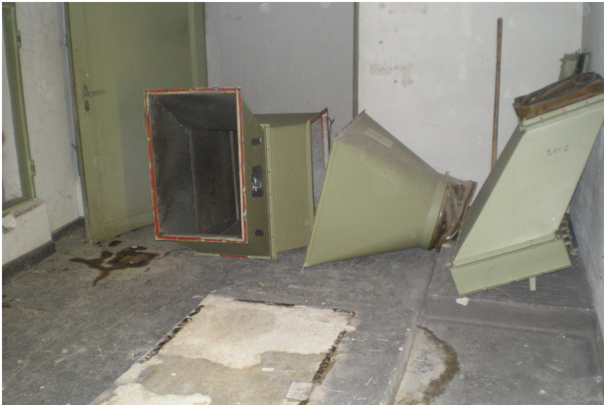
Abb. 4-3 Teilstücke der Zuluftanlage 2
