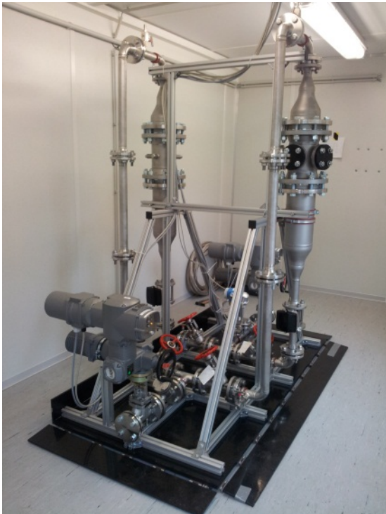
Abbildung 4.4.4-1: Mobiler, TÜV-geprüfter Korrosionsteststand
