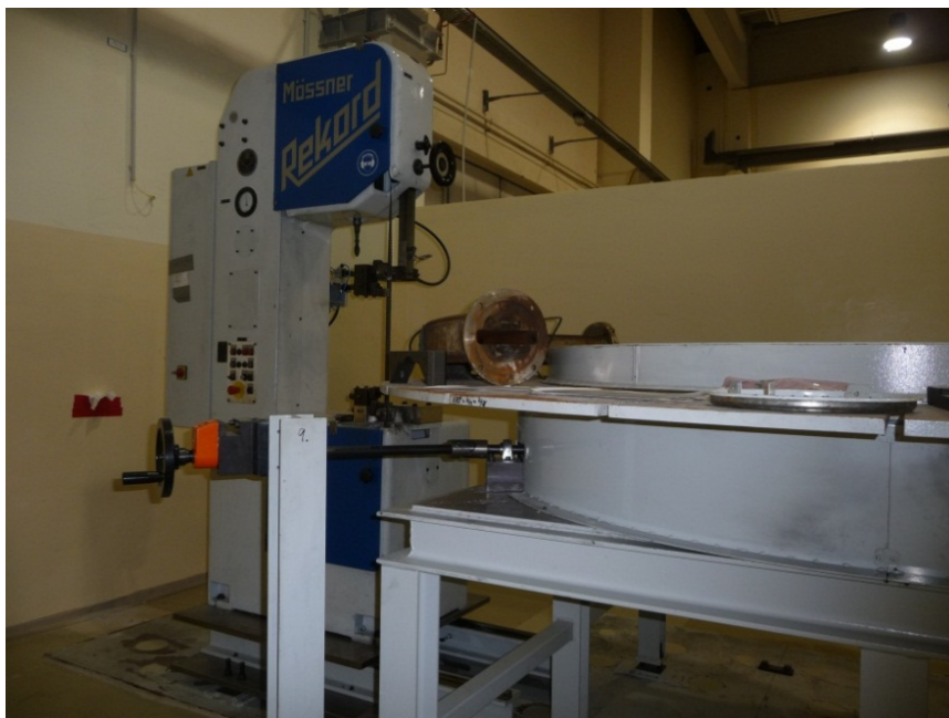
Abbildung 4.2.6-2: Bandsäge SSF 520 im Gebäude 886
