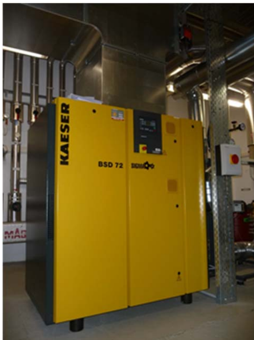
Abbildung 4.2.6-3: KAESER-Druckluftstation im Raum 018 des Gebäudes 885
