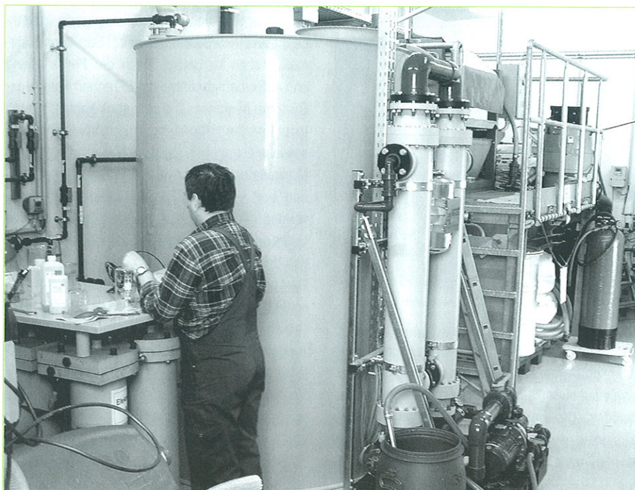
Wasserreinigung in der LARA
